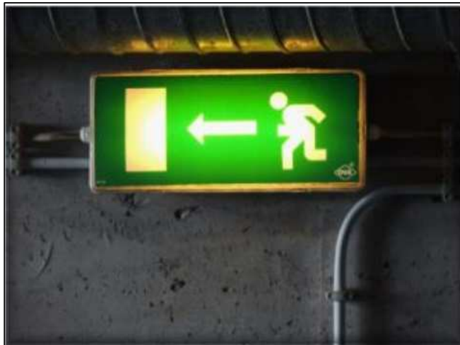
Figura 9 - Sinalização iluminada com fonte de luz própria
