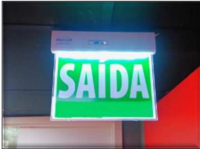
Figura 8 - Sinalização iluminada com fonte de luz própria
